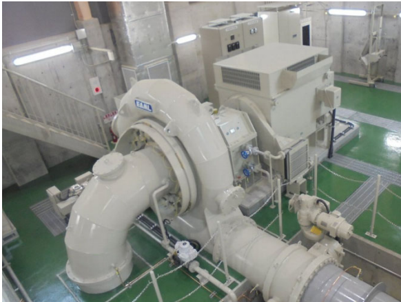
水車・発電機
